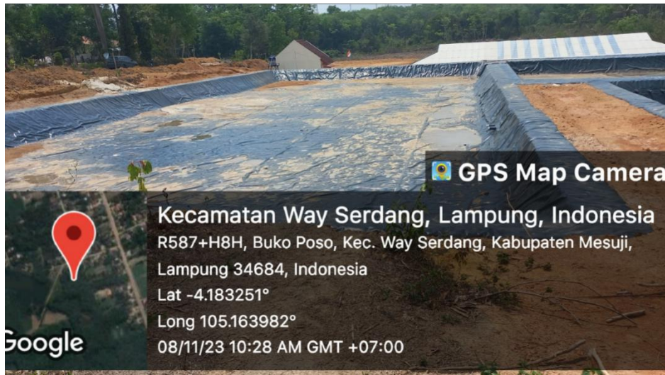
Gambar 10. Kolam Tandon Penampungan Air
