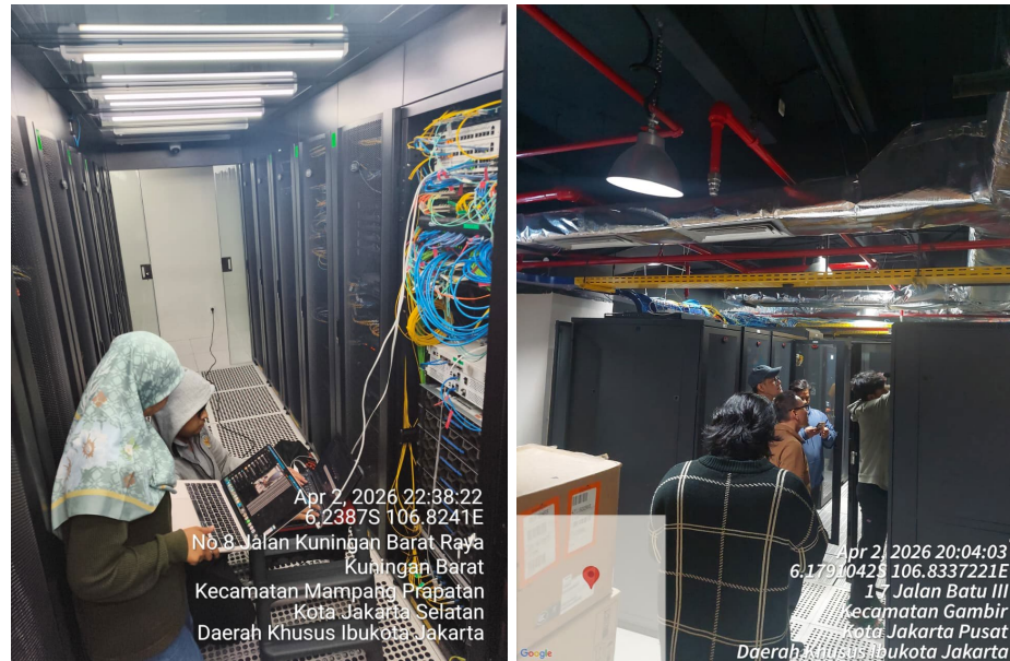
Gambar 17. Kegiatan pembaruan firmware pada perangkat switch di Data Center serta perangkat firewall FortiGate di lokasi Gambir
